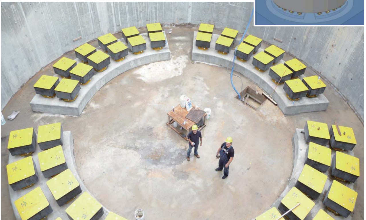
120tカウンターブローハンマーの防振例 防振装置総支持荷重:約1700トン
